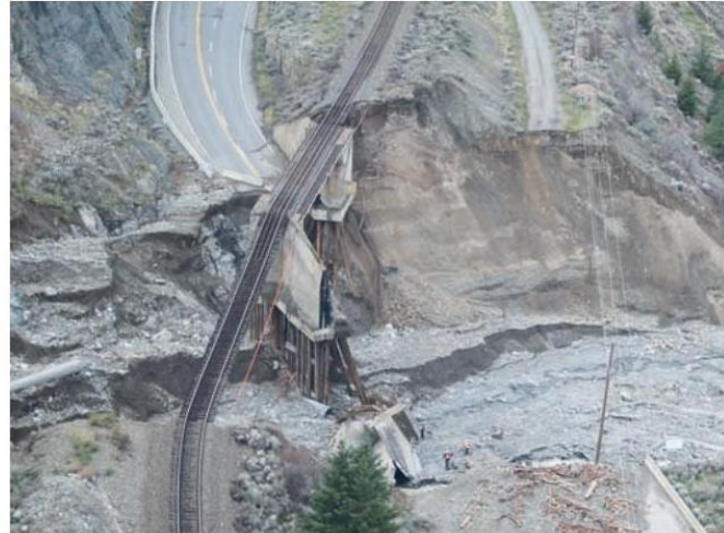
Hình 6 Thiệt hại đối với Hàm chui Đồi Tank trên Quốc lộ 1 ở British Columbia, Canada, do sự kiện mưa cực đoan vào tháng 11 năm 2021
